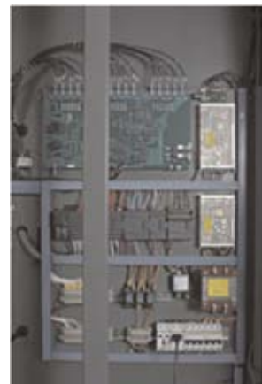
Секция модулей управления
